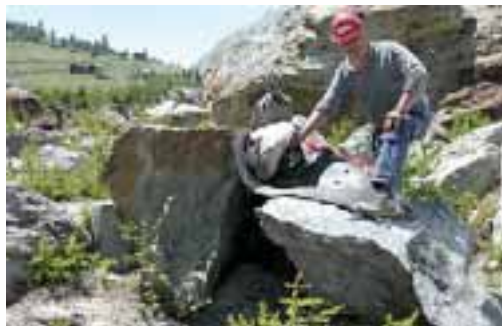
13 Das Resultat: Der Stein wurde erfolgreich mit dem Rock Cracker in mehrere Teile gespalten.
